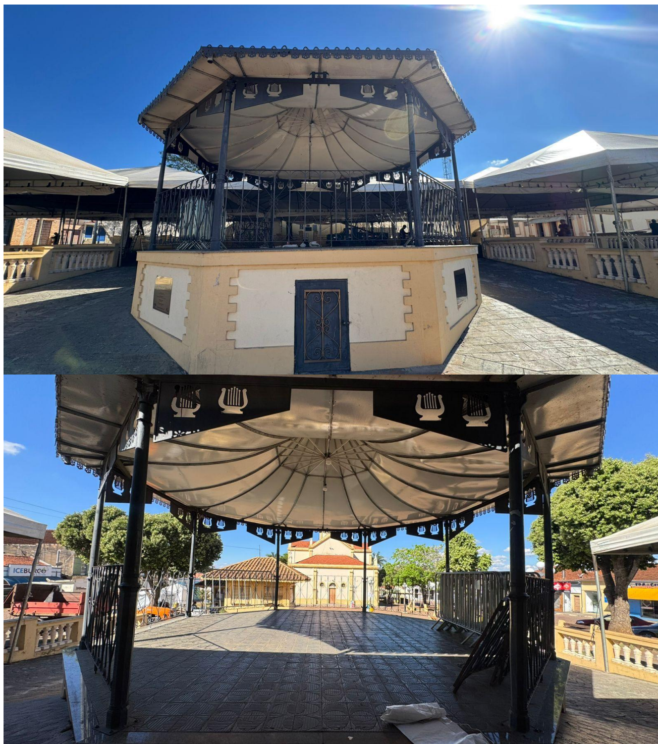
Figura 2 – Coreto existente, registrando as condições atuais do forro, cobertura, guarda-corpo, estrutura, paredes e piso, elementos a serem preservados e revitalizados por meio de pintura.
