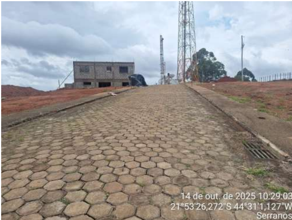
Foto 22 - Vista da rua rua projeta 2, com sentido para torre (fundos), com infraestrutura executada, com excessão da rede de energização e iluminação pública; e lotes – Quadra 02 à direita.
